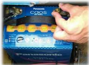
①端子接続部の確認
