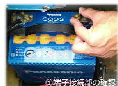
①端子接続部の確認
